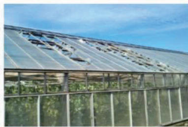
破損した農業用ハウス（藤沢市）
