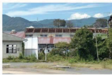
屋根が破損した牛舎（伊勢原市）
