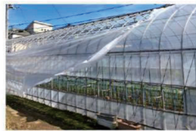
破損した農業用ハウス（寒川町）
