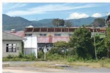
屋根が破損した牛舎（伊勢原市）
