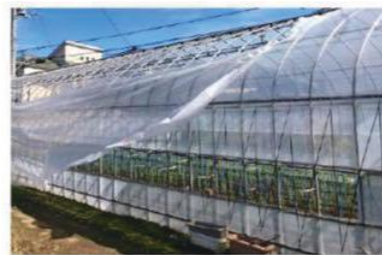
破損した農業用ハウス（寒川町）
