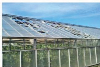
破損した農業用ハウス（藤沢市）
