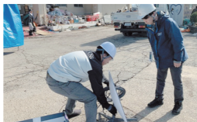
能登半島避難所での 衛星通信システム設置の様子 (写真提供：KDDI株式会社)
